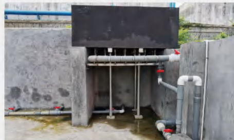
中水回收再净化系统
